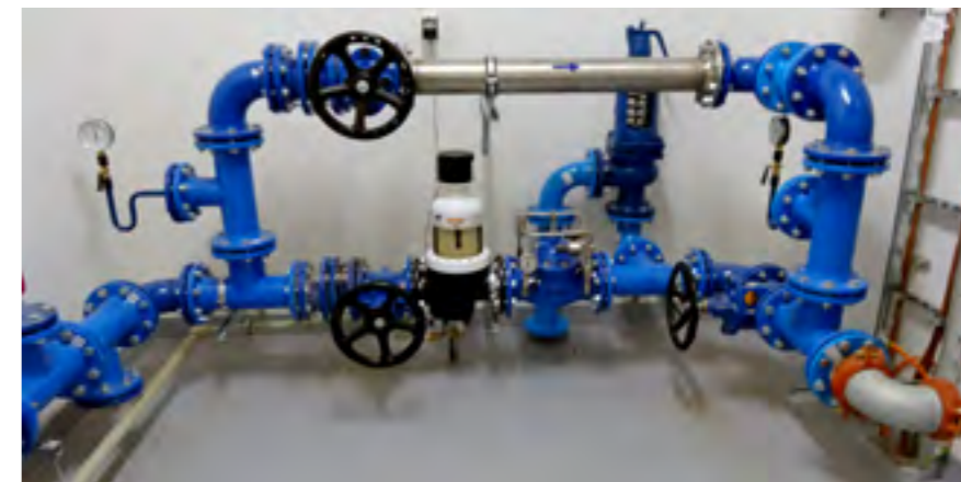
VODOVODNÍ VSTUP STANICE NÁRODNÍ TRÍDA
