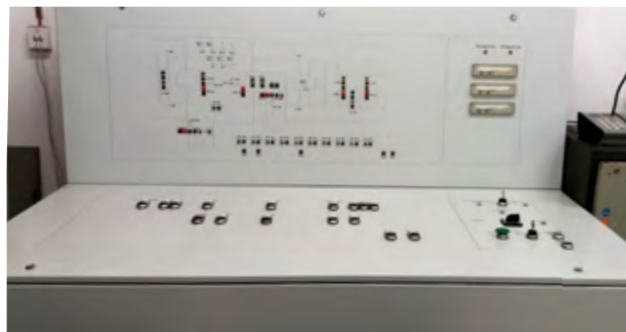
PULT STANIČNÍHO ŘÍDÍČÍHO PRACOVÍŠTĚ (SŘP) SLOUŽÍCÍHO K DÁLKOVÉMU OVLÁDÁNÍ TECHNOLOGIÍ OSM
