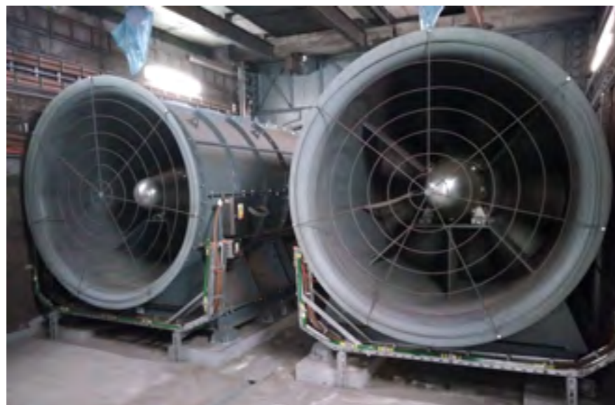
STROJOVNA HLAVNÍHO VĚTRÁNÍ S NOVÝMI VENTILÁTORY APWM POUŽÍVANÝMI V MEZISTANIČNÍM ÚSEKU I. P. PAVLOVA – VYŠEHRAD
