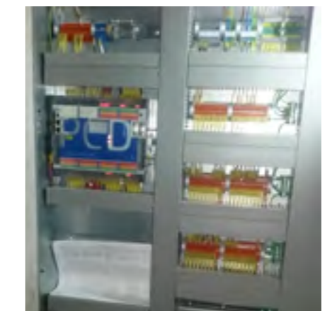
ROZVÁDĚČ OVLÁDÁNÍ HLAVNÍHO VĚTRÁNÍ VE VĚTRACÍ ŠACHTĚ FLORENC – BULHAR
