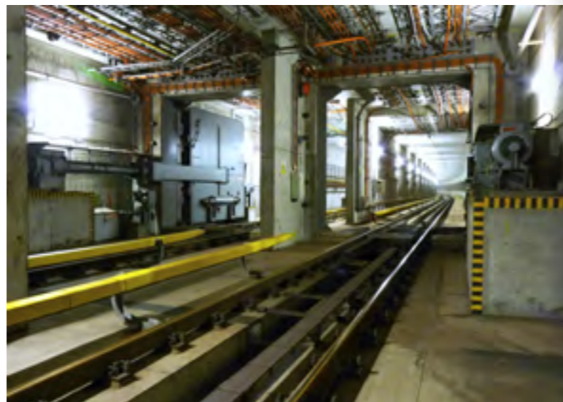
TLAKOVÝ TRAŤOVÝ UZÁVĚR ZT76A V MEZISTANIČNÍM ÚSEKU NÁDRAŽÍ HOLEŠOVICE A KOBYLISY
