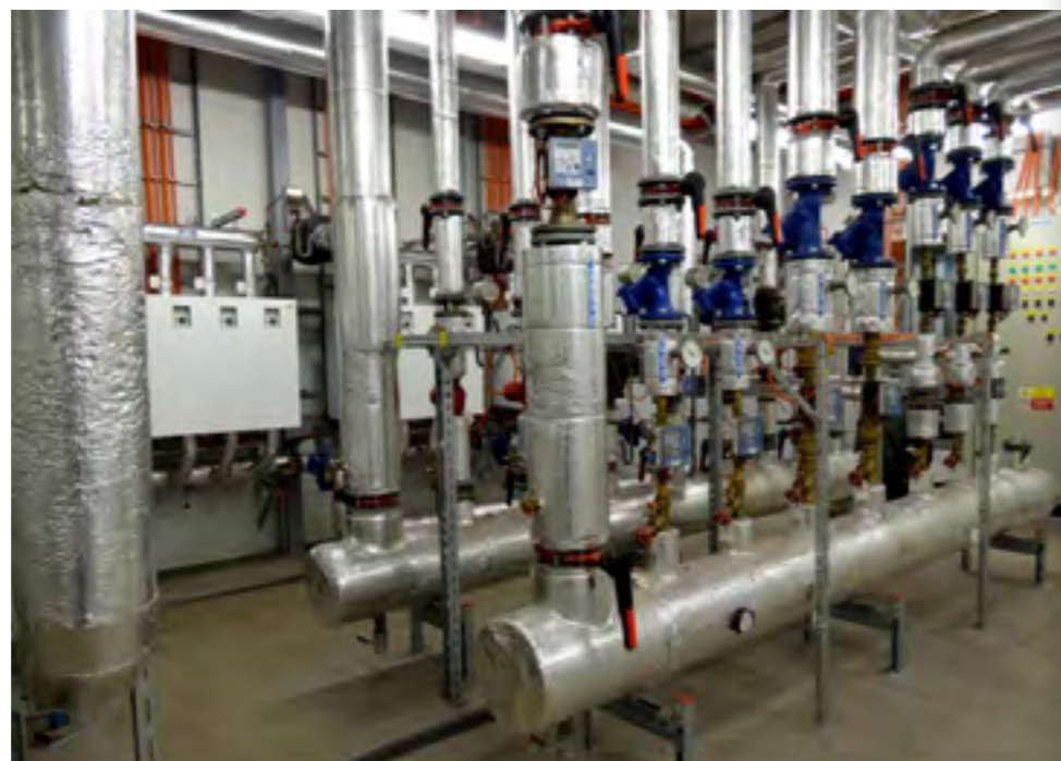
ELEKTROKOTELNA VE STANICI METRA MUZEUM C
