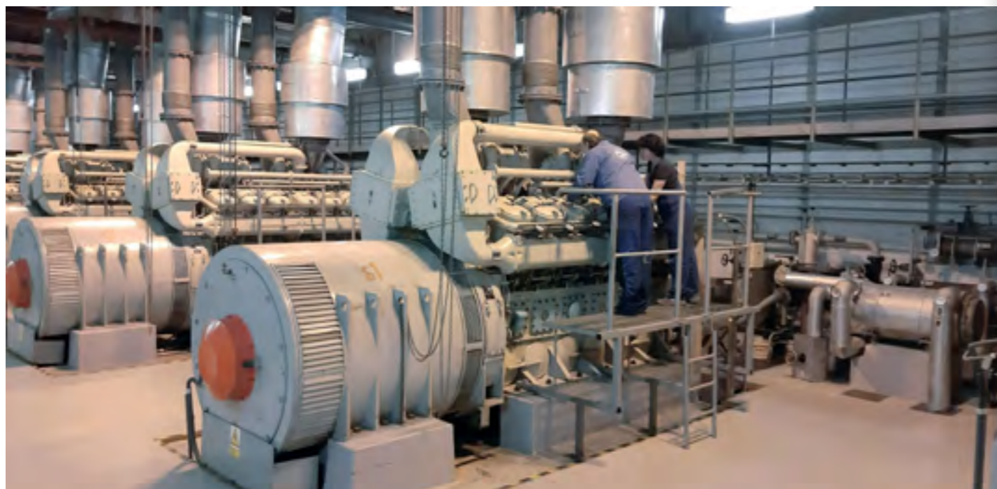
DIESELOVÝ AGREGÁT K 12 V 230 DA U STANICE RADLICKÁ
