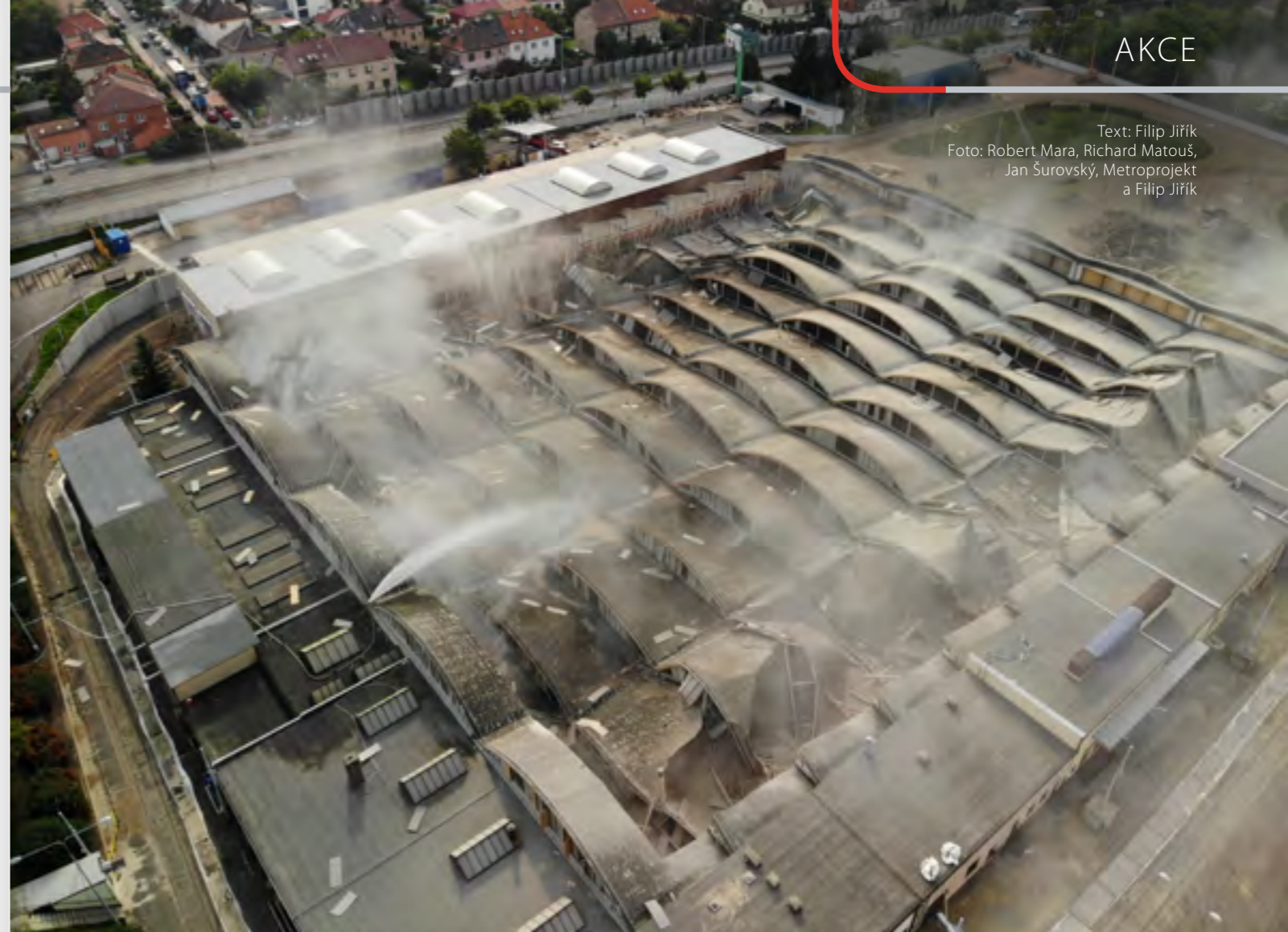
CELKOVÝ POHLED NA DEPONOVAČÍ HALU PO PROVEDENÍ Odstřelu střechy během skrápění ke snížení prašnosti
