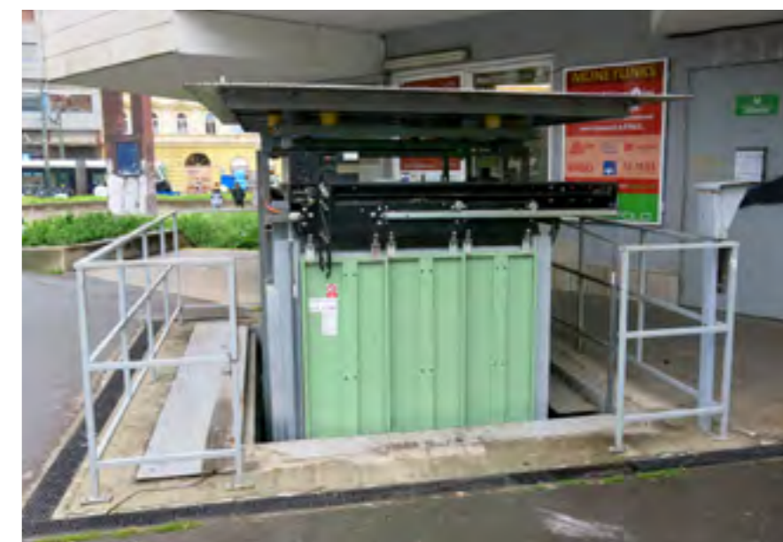
NÁKLADNÍ VÝTAH Č. 186 VE STANICI FLORENC B
