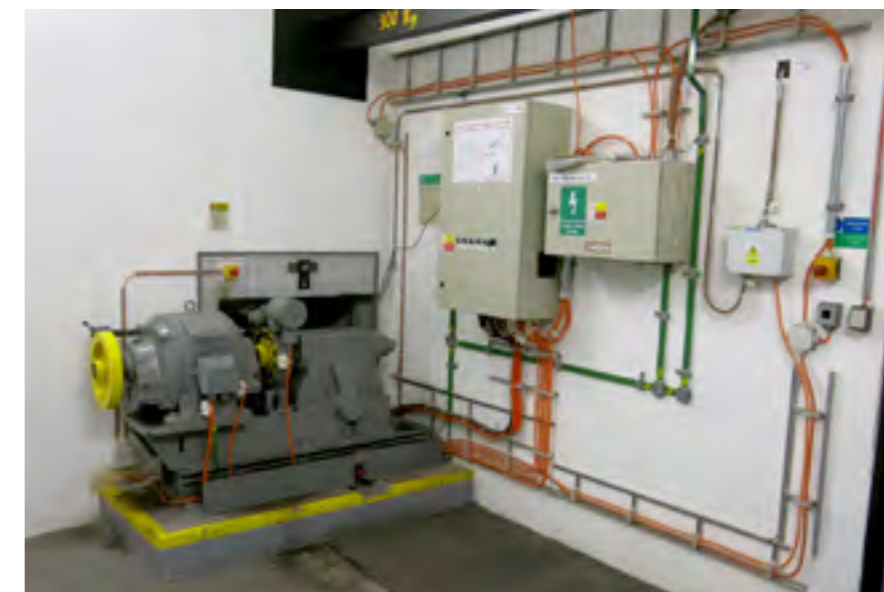
STROJOVNA VÝTAHU Č. 186 VE STANICI FLORENC B
