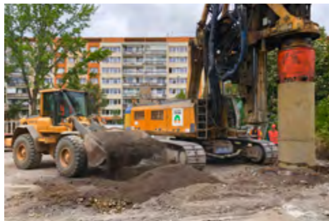
AKTUÁLNÍ ZÁBĚR Z LOKALITY VO-OL (9. 7. 2019) PŘI VRTÁNÍ A BETONOVÁNÍ DĚR PRO BUDOUCÍCH 74 PILOT FOTO: DANIEL ŠABÍK
