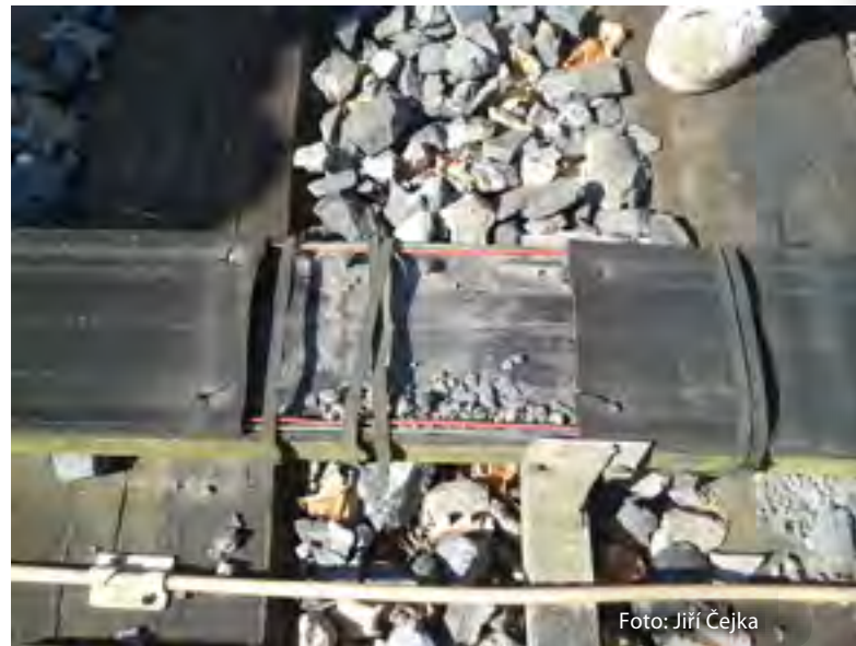
DETAIL OBNAŽENÉHO PROGRAMOVÉHO PÁSU VLAKOVÉHO ZABEZPEČOVAČE PA 135. VE SPODNÍ ČÁSTI KABEL SMYČKY VLAKOVÉHO ZABEZPEČOVAČE LZA
