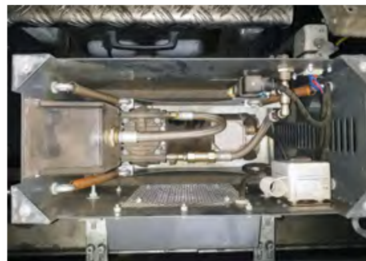
KOMPRESOR MAZACÍHO ZAŘÍZENÍ UMÍSTĚNÝ NA STŘEŠE VOZIDLA 15T
