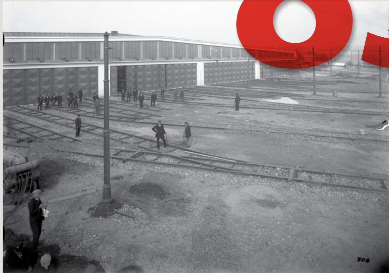
TAKTO ZACHYTL VOZOVNU VOKOVICE FOTOGRAF NA POČÁTKU ŘÍJNA 1932. VENKOVNÍ KOLEJIŠTĚ, KTERÉ SE ZROVNA STAVĚLO, MĚLO CELKOVOU DÉLKU 1,783 KM A OBSAHOVALO 35 VÝHYBEK. UVNITŘ HALY TEHDY BYLO 30 KOLEJÍ O CELKOVÉ DÉLCE 2,623 KM
