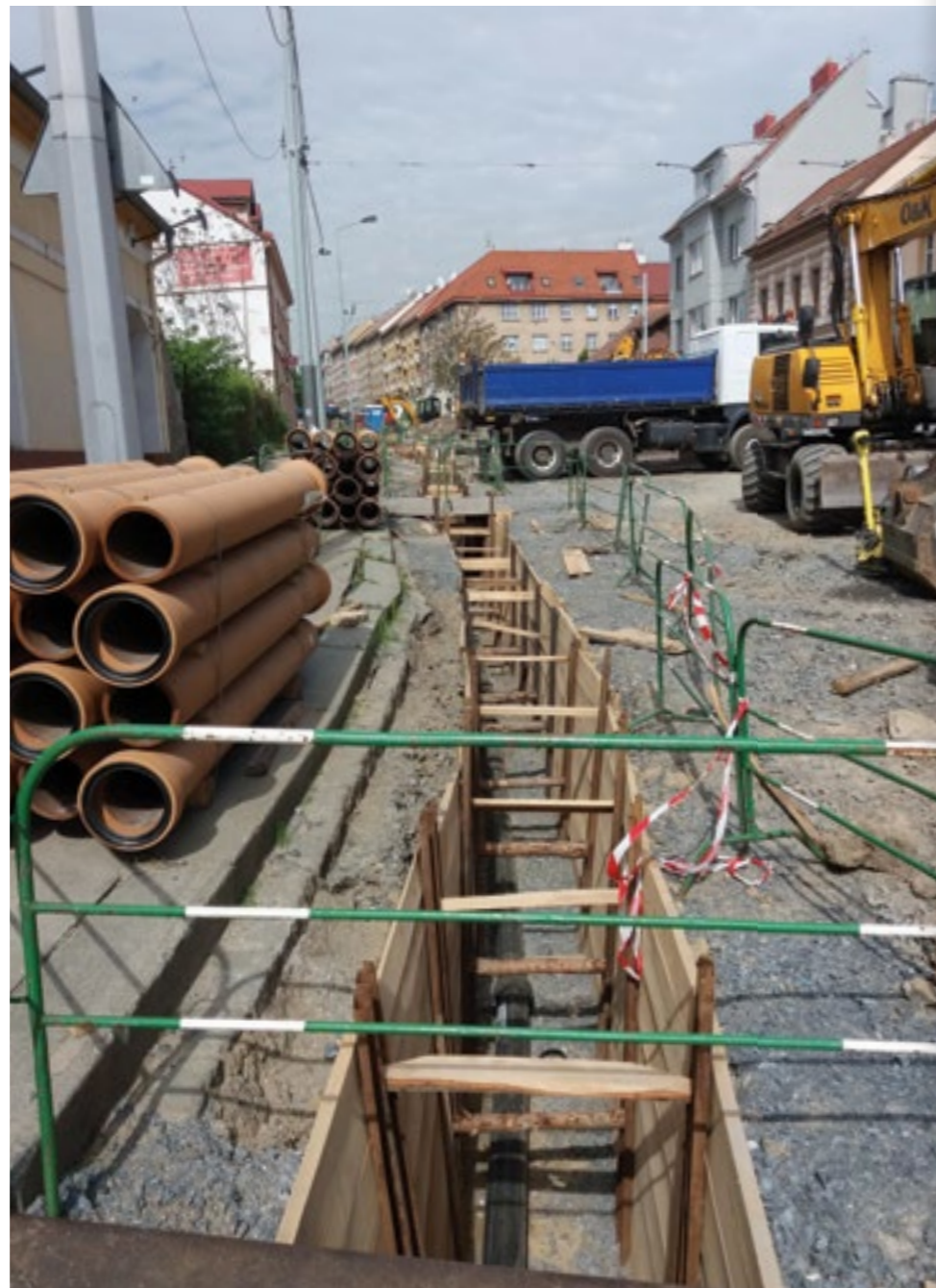
ZENKLOVA K NEPOZNÁNÍ. PŘEDTÍM, NEŽ MOHL PRÁCE ZAHÁJIT DOPRAVNÍ PODNIK, MUSELY BÝT PROVEDENY INŽENÝRSKÉ SÍTĚ POD VOZOVKOU. SNÍMEK BYL POŘÍZEN NA KONCI DUBNA 2018 POD ZASTÁVKOU VOSMÍKOVÝCH
