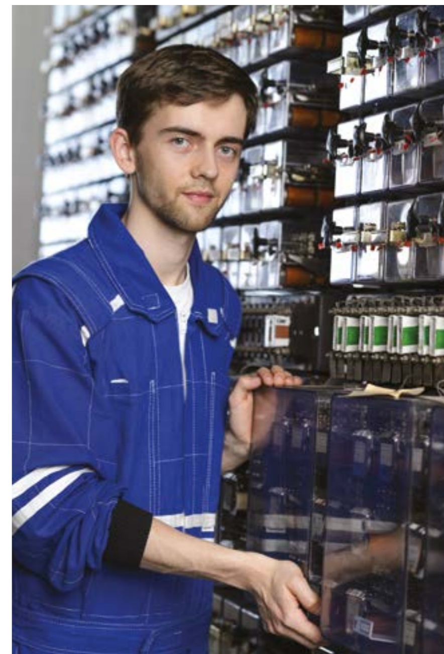
V RELÉOVÉ MÍSTNOSTI SE STARÁME O ÚDRŽBU A PŘÍPADNĚ ŘEŠÍME PORUCHY. VÍCEMÉNĚ FUNGUJEME JAKO POGHOTOVOST, ŘÍKÁ K PRÁCI NA KAČEROVSKÉM STAVĚDLĚ DEPA JAKUB ŠKVOR
