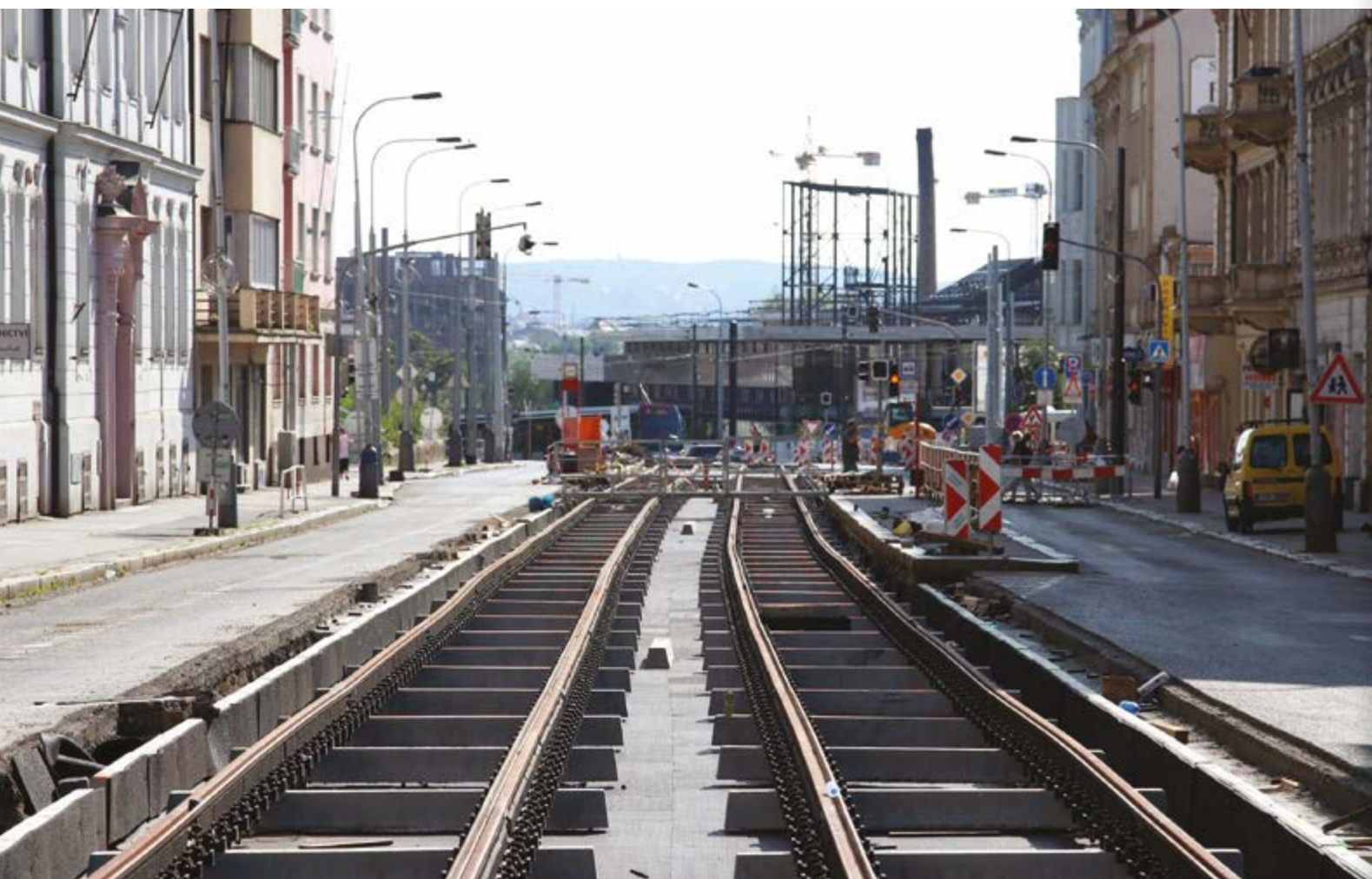
SOKOLOVSKÁ ULICE, MANIPULAČNÍ TRATĚ S VYSKLÁDANÝMI KOLEJNICEMI. V POZADÍ KŘÍŽOVATKA HORNÍ PALMOVKA A ROZESTAVĚNÁ RADNICE PRAHY 8 (31. 5. 2017)
