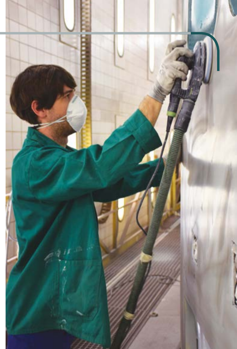
JIŘÍ MEDŘICKÝ V OPRAVNĚ TRAMVAJÍ DPP PŘI BROUŠENÍ VRSTVY, TZV. PLNICE, PO NĚMŽ BUDE NA TRAMVAJI KT4 NÁSLEDOVAT NÁSTRÍK LAKU
