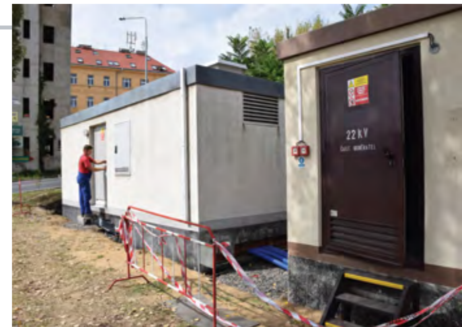
PRO NAPÁJENÍ TRAKČNÍHO VEDENÍ BUDE SLOUŽIT DVOJICE OBJEKTŮ MOBILNÍ MĚNIRNY (31. 8. 2017)
