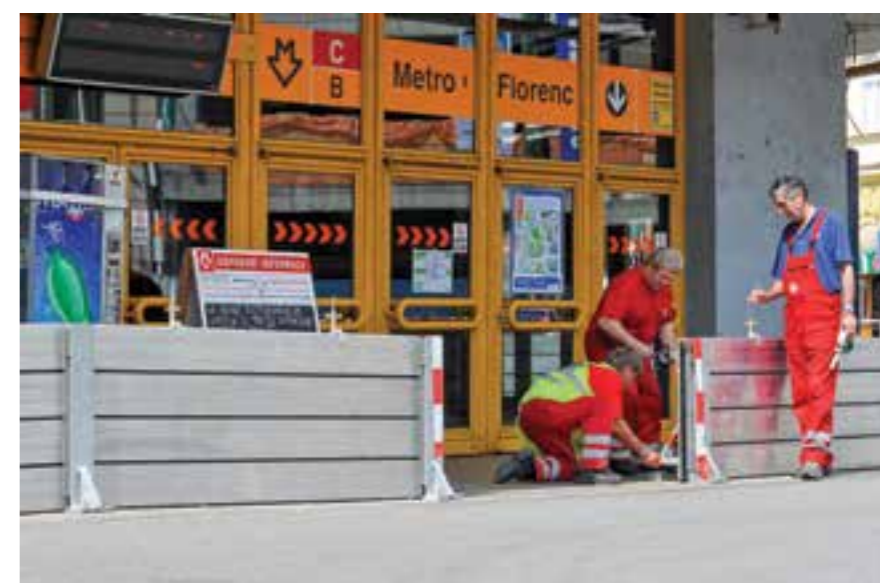
I PRAHA MÁ „SVĚ“ POVODNĚ ZA SEBOU. PŘED NÁSLEDKY JSOU STANICE METRA CHRÁNĚNY MOBILNÍMI BARIÉRAMI
