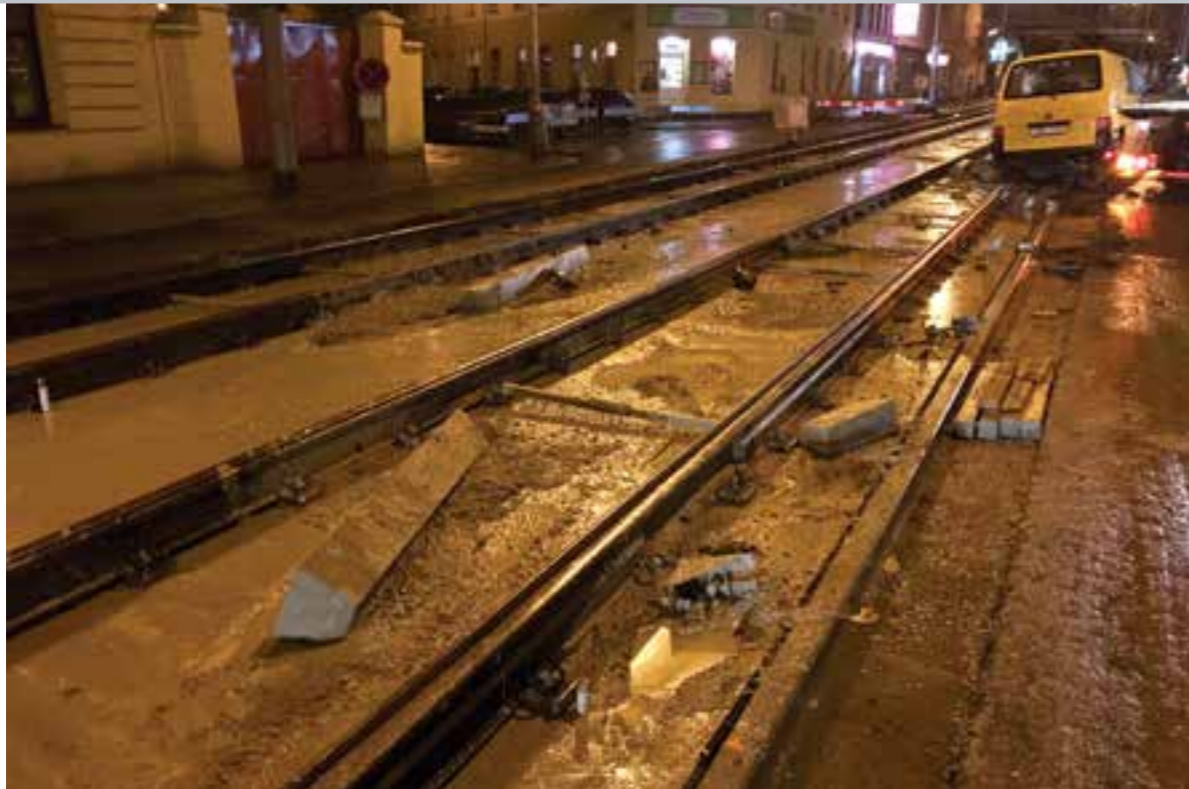
V LISTOPADU DOŠLO K NEPŘÍJEMNÉ UDÁLOSTI. CIZÍ VOZIDLO PROJELO VEČER SKRZ ZÁKAZ VJEZDU A POŠKODILO NĚKOLIK DESÍTEK METRŮ ČERSTVÉ ZABETONOVANÉ TRATI. CELÝ ÚSEK SE MUSEL VYBOURAT A POSTAVIT ZNOVU. DÍKY NAsAZENÍ PRACOVNÍKŮ VRCHNÍ STAVBY BYL DODRŽEN PŮVODNÍ TERMÍN OTEVŘENÍ ÚSEKU 22. 11. PRO SILNIČNÍ VOZIDLA, KTERÝ BYL DŮLEŽITÝ PRO NÁHRADNÍ AUTOBUSOVOU DOPRAVU
