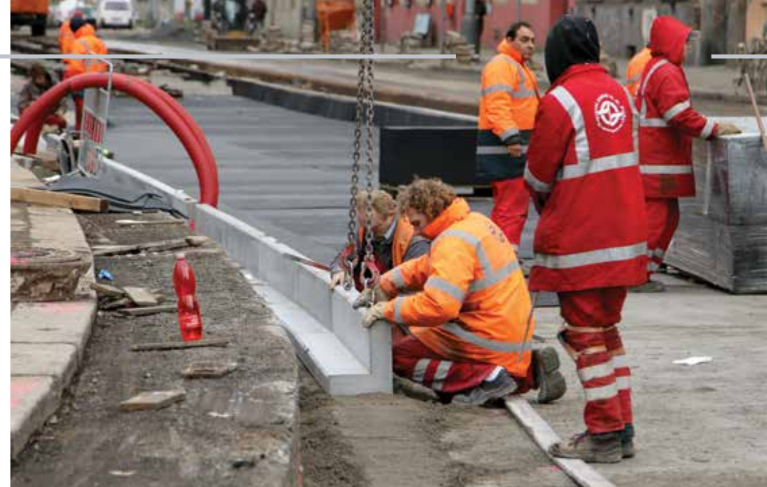
SOUČÁSTÍ REKONSTRUKCE TRATI BYLA I PROTIHLUKOVÁ OPATŘENÍ. ŽELEZOBETONOVÉ L PROFILY TVOŘÍ KONSTRUKCI ANTIVIBRAČNÍ VANY. POKLÁDKA L PROFILŮ MUSÍ BÝT PŘESNÁ
