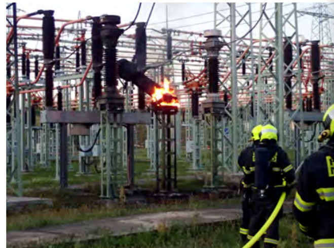
POŽÁR TRAFOSTANICE, UL. TEPLÁRENSKÁ, 30. 6. 2019
