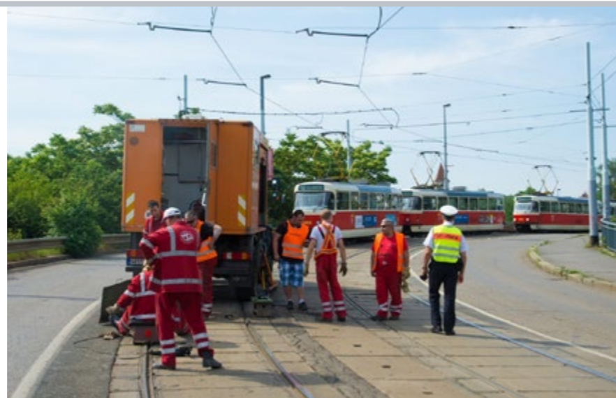
NA „NOVÉM“ MOSTĚ JE PANELOVÁ TRATĚ (PŮVODEM Z ROKU 1988) JIŽ V NEÚNOSNÉM STAVU, A TO NAVZDORY ÚPLNÉ VÝMĚNĚ KOLEJNIC V ROCE 2013. JEDNU Z HAVÁRIÍ ZVĚČNIL JIŘÍ BENEŠ 31. KVĚTNA 2018
