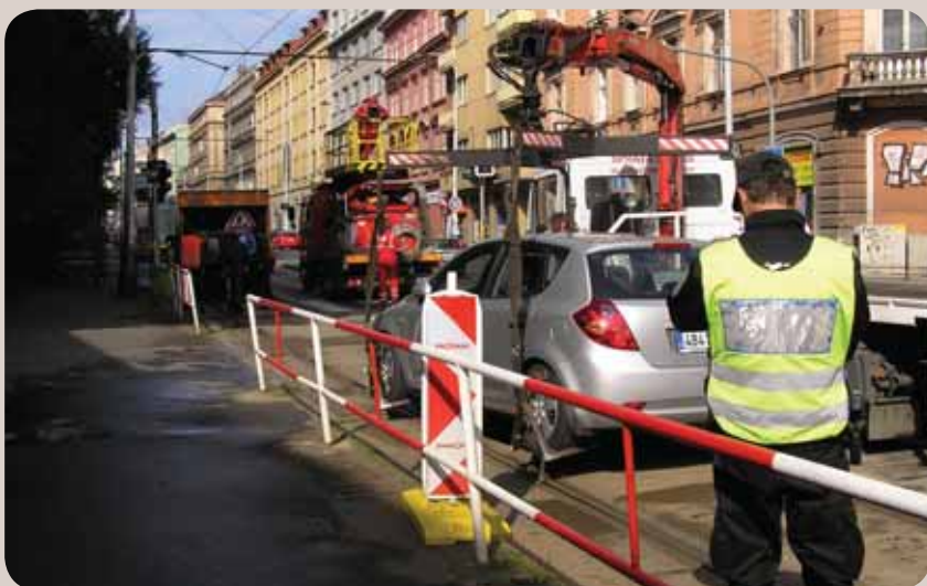
Nerekonstruovaný úsek u Bertramky si oblíbili automobilisté a parkovali na kolejích. Že svým přístupem znemožnili vykonat běžnou údržbu, je nenapadlo. Díky Městské policii si snad budou příště lépe pamatovat, že na kolejích se neparkuje ani při výluce.
