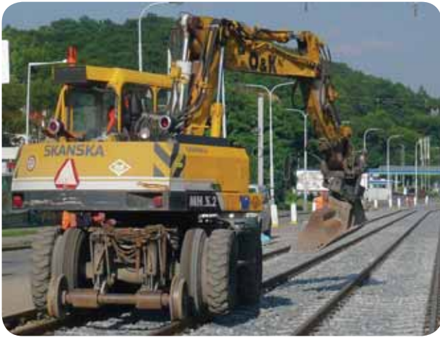
Na rekonstrukci tratě na Plzeňské ulici se podílela také firma Skanska se svými stroji. 8. 8. 2010
