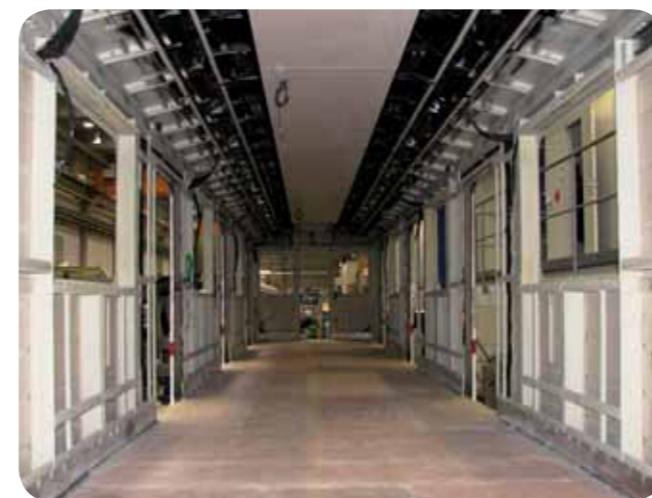
Záběr na připravenou kabeláž a podlahu před pokládkou svrchní vrstvy podlahoviny ALTRO X25
