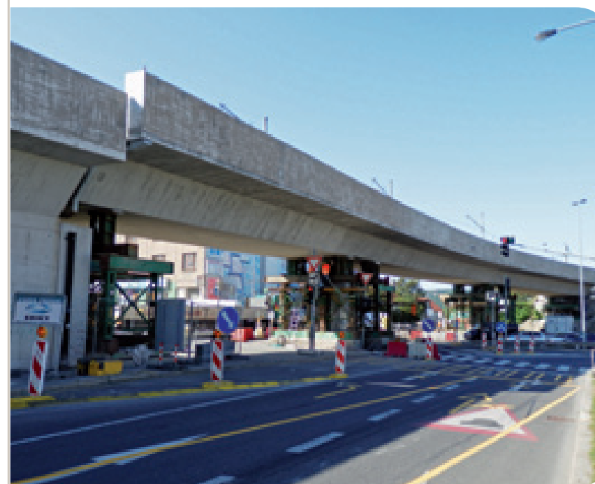
Mohutné lisy zvedly estakádu, aby bylo možné vyměnit ložiska a uložit objekt do správné polohy
