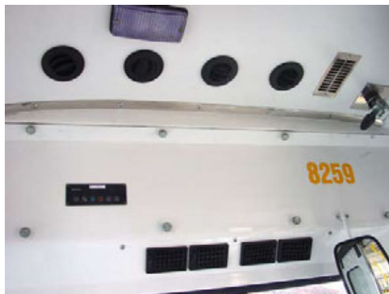
Detailní pohled na výdechy klimatizace v kabině.
