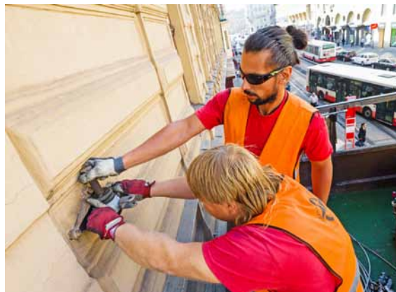
Ukotvení nového domovního závěsu pro nosné lano trolejového vedení v podání montérů Tomáše Kubalíka a Davida Langšádla.
