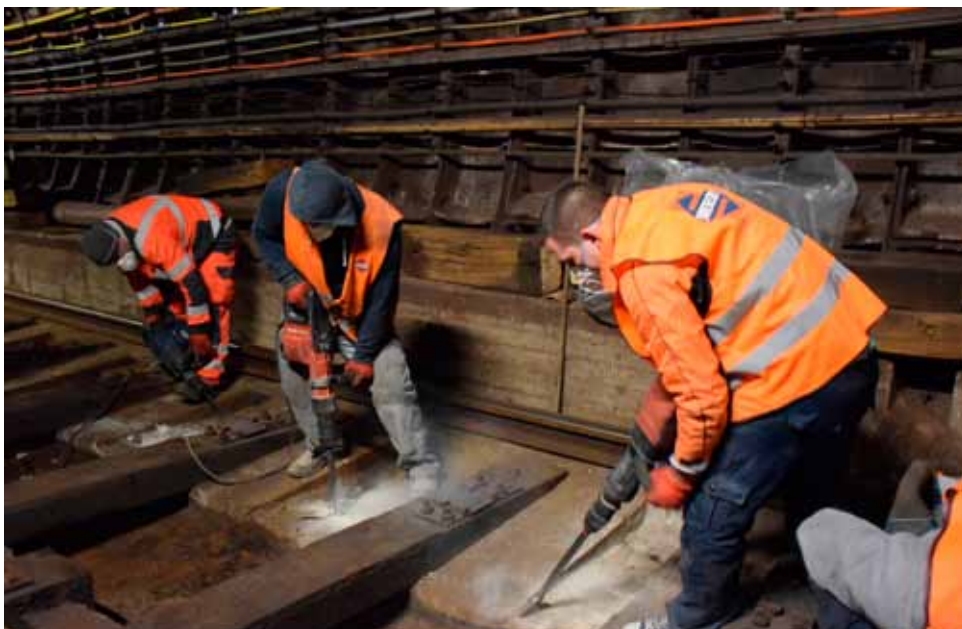
Výlukový víkend první – drsná práce při vybourávání každého druhého původního dřevěného pražce.
