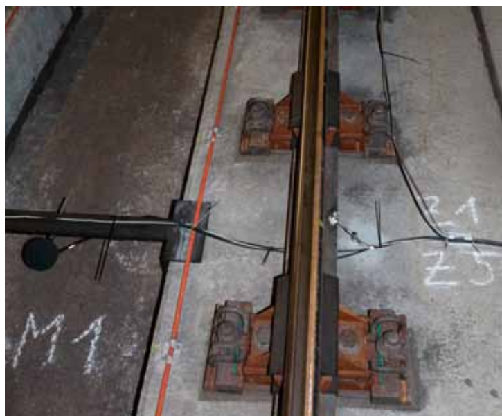
Snímače zrychlení Z1 a Z5 pro měření vibrací přenášených na kolejnici (vpravo) a mikrofon M1 (vlevo).
