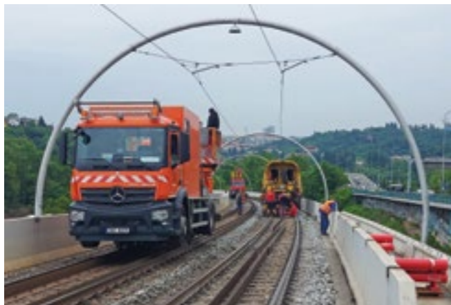
ZÁVĚREČNÉ DNY VÝLUKY BYLY VE ZNAMENÍ KOORDINOVANÉ SPOLUPRÁCE VŠECH ZHOTOVITELŮ PRACÍ. NA ESTAKÁDĚ PROBIHALO 20. KVĚTNA 2020 SVAŘOVÁNÍ KOLEJNIC VE SMĚRU DO CENTRA A KONTROLA TROLEJÍ VE SMĚRU Z CENTRA
