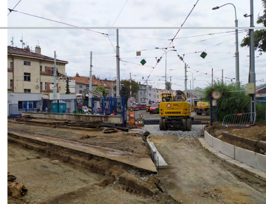
SNÍMEK Z 22. KVĚTNA 2020 ZE ZAČÁTKU STAVBY. VÝLUKA PROBIHALA OD KŘIŽOVATKY VINICE K VRATŮM VOZOVNY STRAŠNICE
