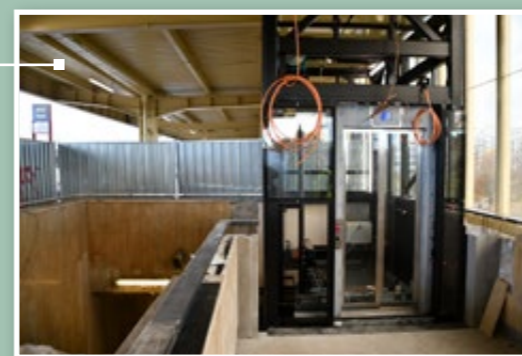
Výtah spojující autobusový terminál s úrovní vestibulu stanice metra
