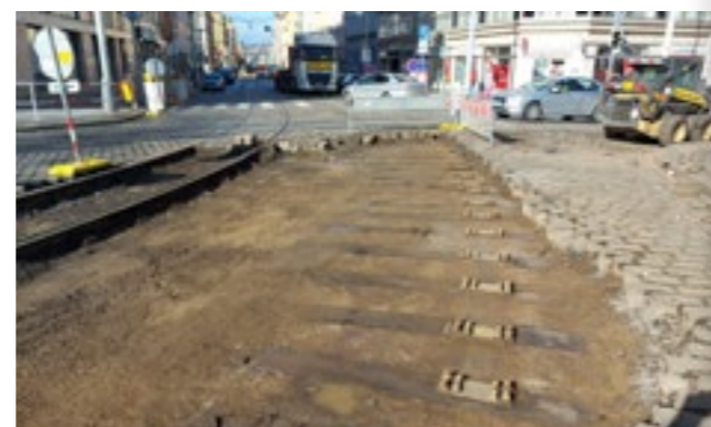
NA SNÍMKU Z 12. 3. 2021 JE PATRNÉ, ŽE OD OPTIMALIZACE OBLOUKU V ROCE 1995 NENÍ VNITRNÍ KOLEJNICE OBLOUKU DO CENTRA NA PRAŽCÍCH, ALE VOLNĚ NA BETONOVÉ DESCE FOTO: JIŘÍ BENEŠ
