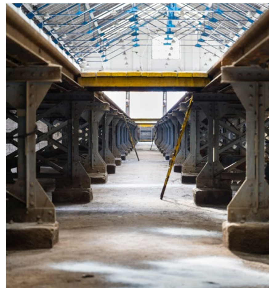
PODPĚRY V PRVNÍ HALE V ZÁŘÍ 2018, TEDY TĚSNĚ PŘED JEJICH REKONSTRUKCÍ
