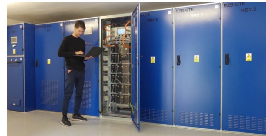
ÚLOŽIŠTĚ TRAKČNÍ ENERGIE V MĚNÍRNĚ TROJSKÁ SE NACHÁZÍ MIMO OSTATNÍ TECHNOLOGII MĚNÍRNÝ. MÍSTNOST PŮVODNĚ SLOUŽILA JAKO GARÁŽ. V LEVÉ SKŘÍNI JE VYPÍNAČ. VE DVOU DALŠÍCH JSOU MĚNIČE. SAMOTNÉ BATERIE JSOU VE ČTYŘECH SKŘÍNÍCH VPRAVO
