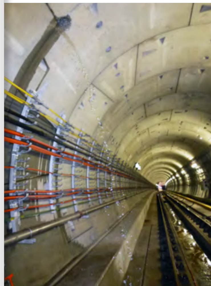
KDYŽ SE PAN PROJEKTANT PŘEKOUKNUL A VRTÁK SE TREFIL, KAM NEMĚL... NARUŠENÍ TUNELU METRA U STANICE BOŘISLAVKA PŘI VÝSTAVBĚ DEVELOPERSKÉHO PROJEKTU Z 21. ŘÍJNA 2018
