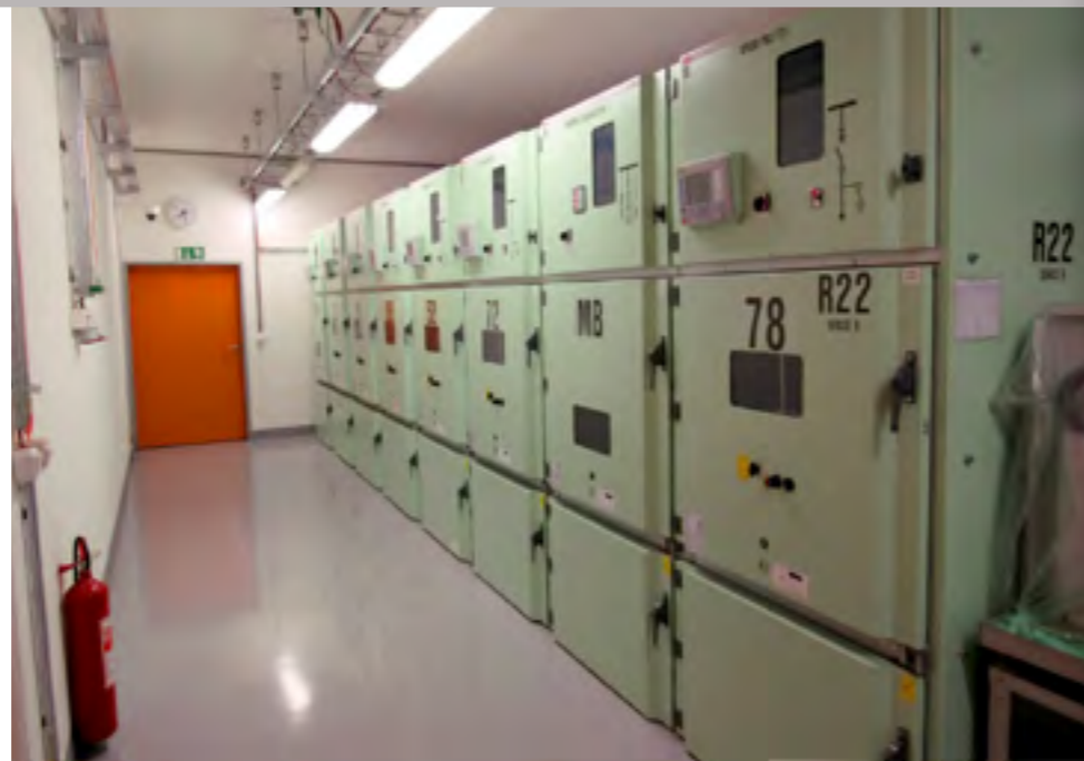
ROZVÁDĚČ 22KV MĚNÍRNY A DISTRIBUČNÍ TRANSFORMOVNY VE STANICI NEMOCNICE MOTOL
