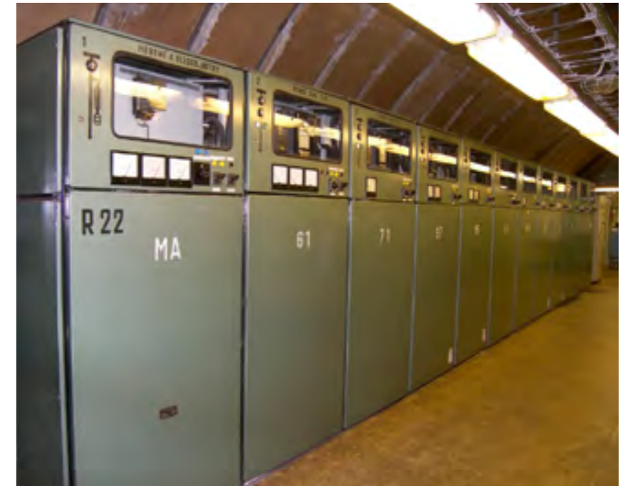
ČÁST DISTRIBUČNÍ TRANSFORMOVNY VE STANICI FLORA
