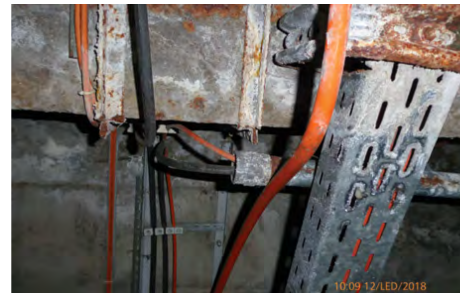
STANICE VLTAVSKÁ, LEDEN 2018 – ŽELEZOBETONOVÁ KONSTRUKCE V POKROČILÉM STÁDIU DEGRADACE
