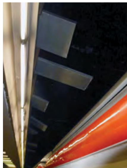
U STANICE S DOŽÍVAJÍCÍ PŮVODNÍ KONSTRUKCÍ HROZÍ PRŮSAKY, NA NĚŽ JAKO PRVNÍ POMOC PLATÍ TZV. ORGANIZOVANÉ SVODY VODY (STANICE DEJVICKÁ, BŘEZEN 2016)
