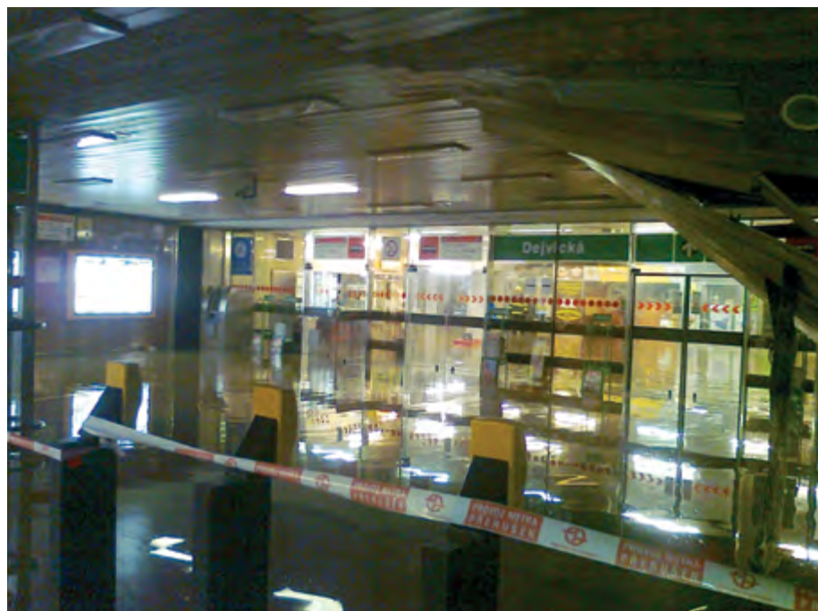
PODZEMNÍ TSUNAMI PŘIPOMÍNÁLY NÁSLEDKY NARUŠENÍ VODOVODNÍHO ŘADU NAD STANICÍ DEJVICKÁ V DOBĚ REKONSTRUKCE JEJÍ STROPNÍ DESKY V ROCE 2013
