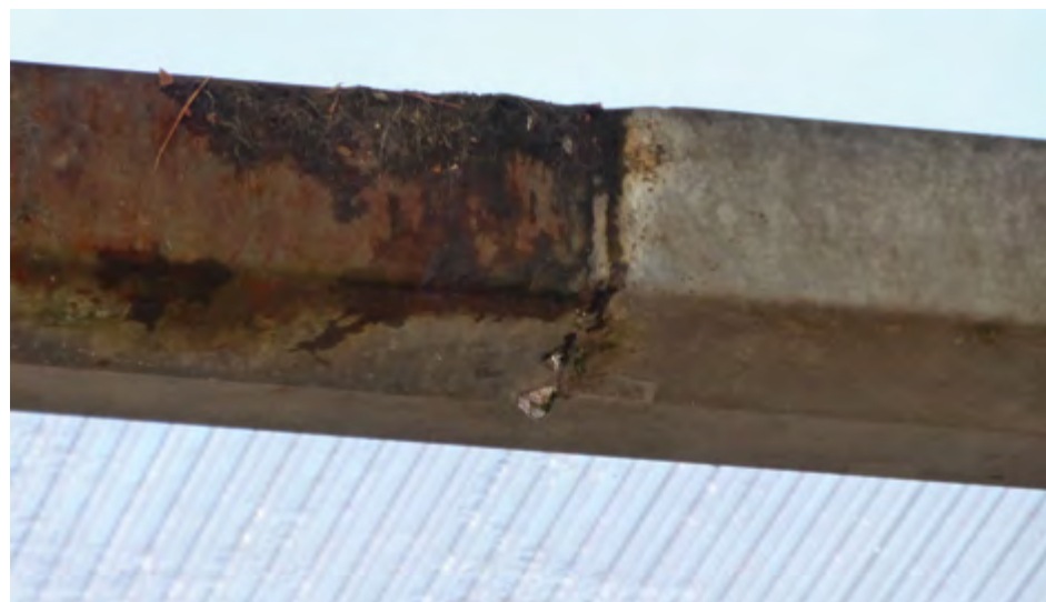
UKÁZKA PROREZIVÉHO SVODU VODY (STANICE CHODOV, PROSINEC 2017)
