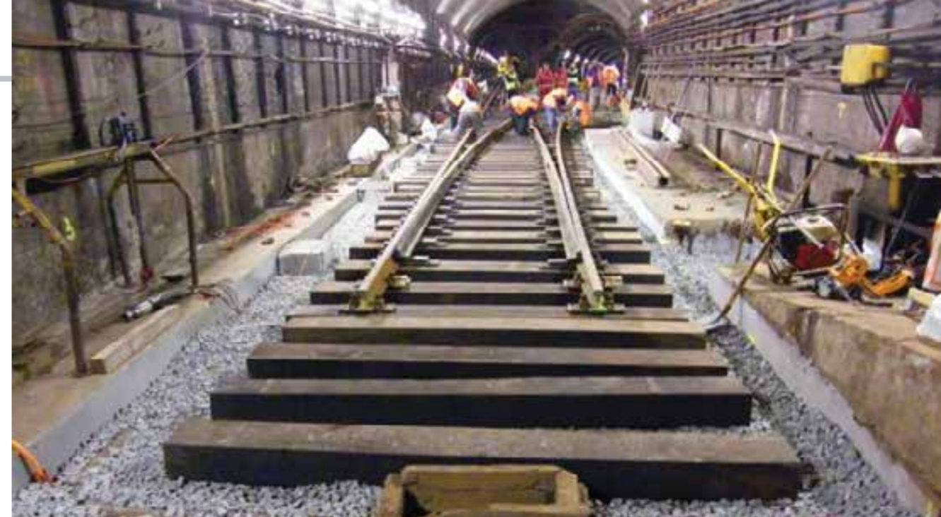
HISTORICKY PRVNÍ VÝMĚNA DŘEVĚNÝCH PRAŽCŮ VE ŠTĚRKOVÉM LOŽI: VÝHYBKA Č. 2 V PRVNÍ KOLEJI STANICE I. P. PAVLOVA, VELIKONOCE 2012
