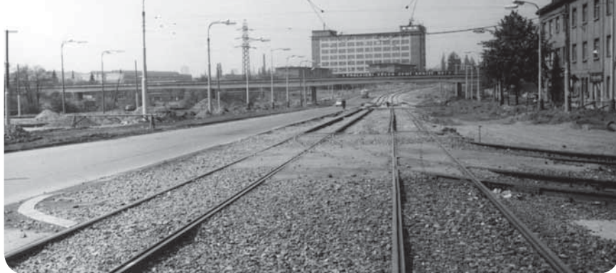
Akce Poděbradská I dne 7. května 1972. Stav prací u křižovatky s Kbelskou ulicí. Foto: Jiří Čermák
