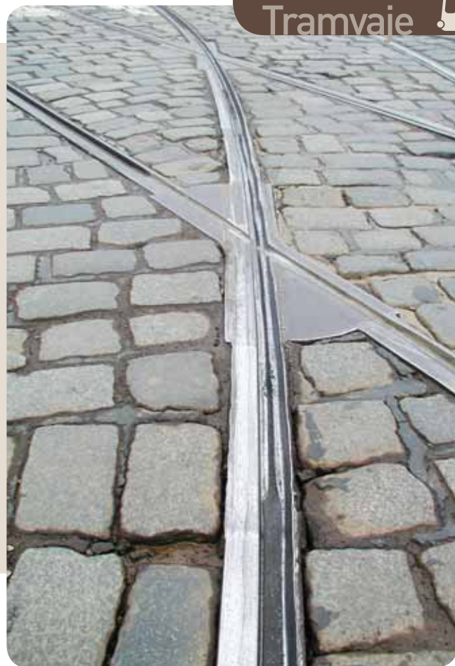
Nesprávným způsobem pojiždění zdeformovaná srdcovka v Praze.
