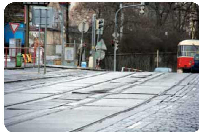
Nedávná minulost. Stav trati byl opravdu již neúnosný
