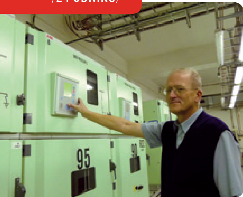
Elektrická stanice se rekonstrukcí dostala na vyšší stupeň provozní bezpečnosti, a tím i celá stanice metra I. P. Pavlova
