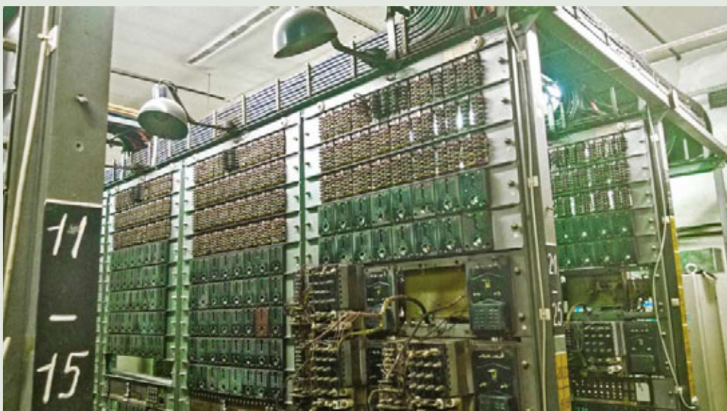
Stojany starého reléového zařízení, v tuto chvíli již mrtvého zařízení s demontovanými relé.
