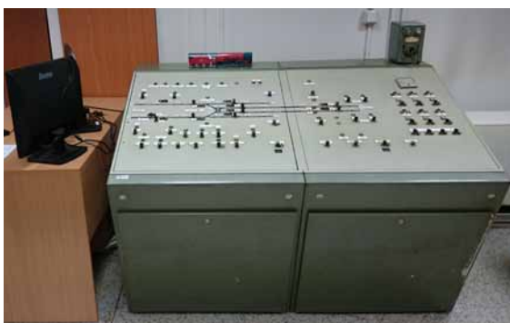
Na začátku roku 2014 se stávající výukové pracoviště rozšířilo o funkční pult staničního reléového zabezpečovacího zařízení AŽD 71.
