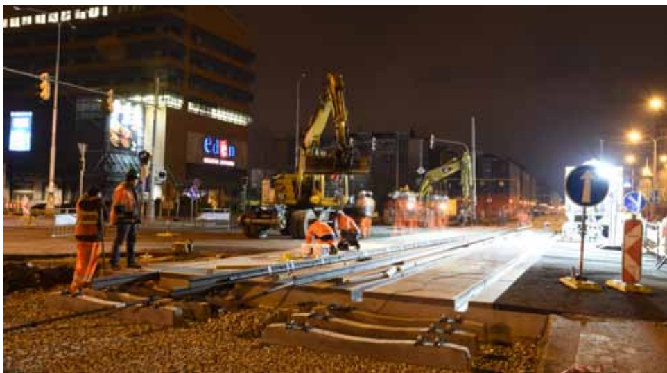
Noční ukládání kolejnic do připravených prefabrikátů. Probíhá krátká totální vyluka přejezdu Bělocerkevská.
