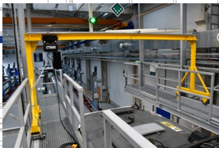
NÍZKOPODLAŽNÍ TRAMVAJE MAJÍ ZNAČNÉ MNOŽSTVÍ TECHNICKÝCH ZAŘÍZENÍ UMÍSTĚNÝCH NA STŘEŠE. Z TOHOTO DŮVODU JSOU MONTÁŽNÍ LÁVKY SOUČASNĚ VYBAVENY DVOJICÍ PORTÁLOVÝCH JEŘÁBŮ, KTERÉ JSOU RUČNĚ VEDENÉ PO KOLEJNÍCÍCH. ZÁROVEŇ NECHYBÍ VYSAVAČ NA ODSTRAŇOVÁNÍ NEČISTOT
