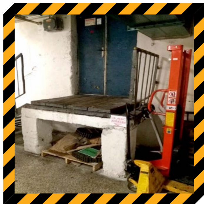
TOTO PRACOVIŠTĚ, Z HLEDISKA BOZP ROZHODNĚ NEVYHOVUJÍCÍ, JE JIŽ MINULOSTÍ
