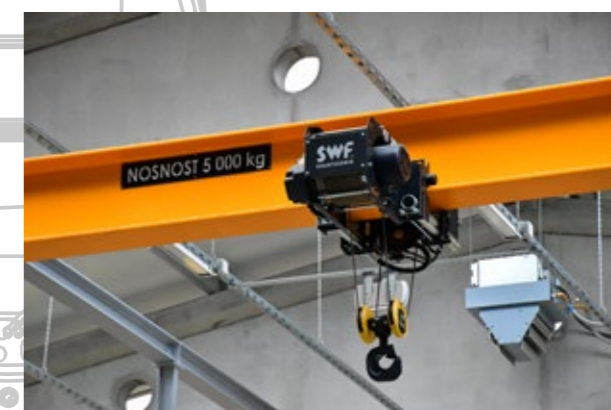
ZÁROVEŇ NECHYBÍ DVOJICE MOSTOVÝCH JEŘÁBŮ (KAŽDÝ S NOSNOSTÍ 5000 KG)
