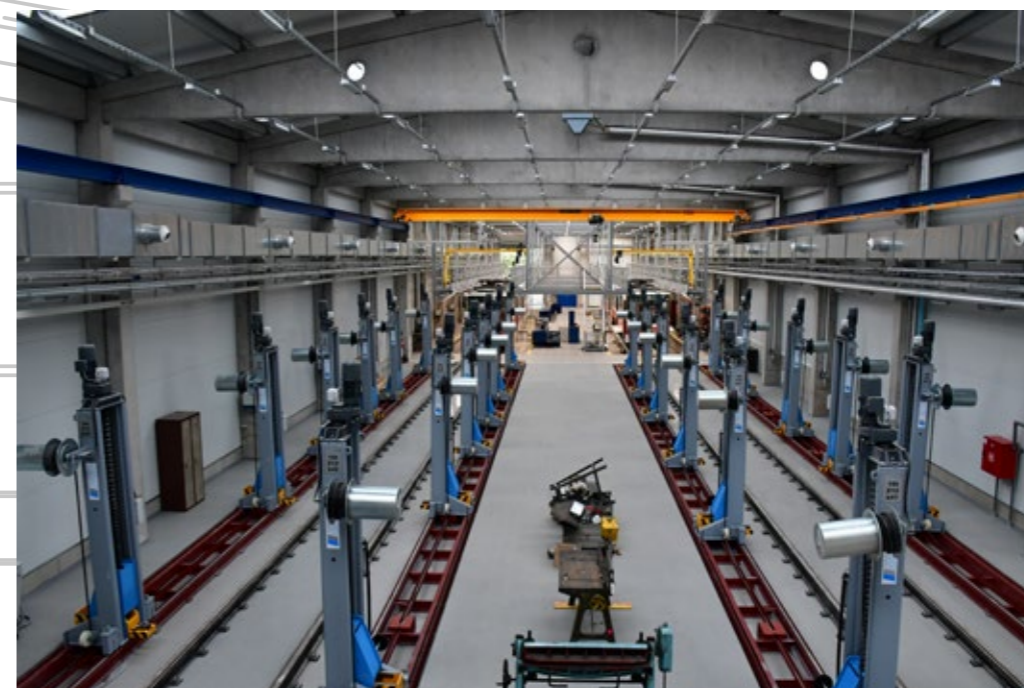
DRUHÁ ČÁST HALY JE OSAZENÁ ZVEDÁKY (TUDÍŽ NENÍ VYBAVENA TRAKČNÍM VEDENÍM), KTERÉ UMOŽŇUJÍ ZVEDNOUT TRAMVAJOVÝ VŮZ A VYVÁZAT PODVOZKY
