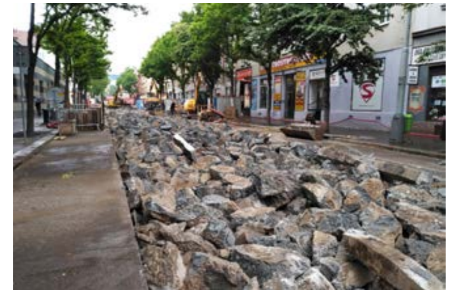
ULICE STAROSTRAŠNICKÁ V ČERVNU 2020 S DOSLOVA VYMLÁCENOU STAROU BETONOVOU DESKOU TRATE
