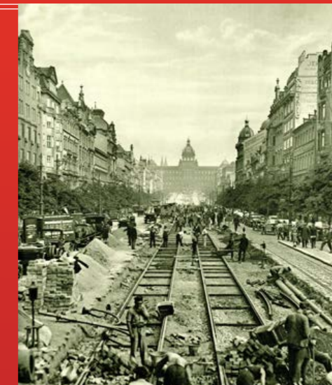
V LETECH 1927 AŽ 1928, TĚMĚŘ TŘICET LET OD ELEKTRIFIKACE TRAMVAJÍ, PROBIHLA NA VÁCLAVSKÉM NÁMĚSTÍ PRVNÍ ZÁSADNÍ PŘESTAVBA OBNAŠEJÍCÍ PŘELOŽKU TRAMVAJOVÝCH KOLEJÍ NA STŘEDOVÝ ZVÝŠENÝ PÁS MEZI SOCHOU SV. VÁCLAVA A MŮSTKEM, REKONSTRUKCI KOMUNIKACE I INŽENÝRSKÝCH SÍTÍ. OSOVÁ VZDÁLENOST JE JIŽ STANDARDNÍCH 2,8 M. V DUBNU 1928 JE TU DOKONČENA TAKÉ REKONSTRUKCE V OBLASTI PŘED MUZEEM. (REPRO Z ČASOPISU PESTRÝ TÝDEN)
