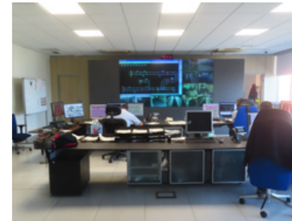
DISPEČERSKÉ STANOVIŠTĚ ŘÍZENÍ PROVOZU VE VOZOVNĚ TRAMVAJÍ
