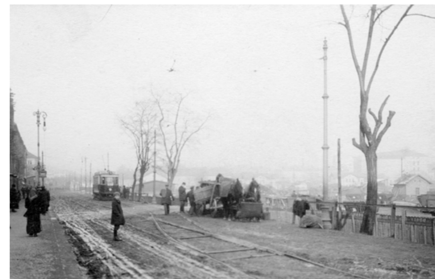
POSLEDNÍ PROSINCOVÝ DEN ROKU 1914 ZACHYTL AMATÉRSKÝ FOTOGRAF ANTONÍN NOVOTNÝ PRVNÍ PRAŽSKOU POVRCHOVOU VÝHYBKU BĚHEM DRUHÉ ETAPY ROZŠÍŘOVÁNÍ RADLICKÉ ULICE
