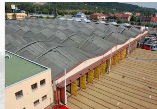
OD ROKU 2013 BYLY EVIDOVÁNY PRVNÍ PROBLÉMY SE STŘEŠNÍ KONSTRUKCÍ, TVOŘENOU Z ŽELEZOBETONOVÝCH KONOIDNÍCH SKORÁPEK O TLOUŠŤCE POUHÝCH PĚTI CENTIMETRŮ, RESPEKTIVE BYL ZAZNAMENÁN JEJÍ NEOBÝKLÝ TVAR VE TŘETÍ LODI VOZOVNY. OD 15. LEDNA 2018 SE NÁSLEDNĚ PŘESTALA ODSTAVNÁ HALA POUŽÍVAT. SNÍMEK JE ZE ZÁŘÍ 2014
