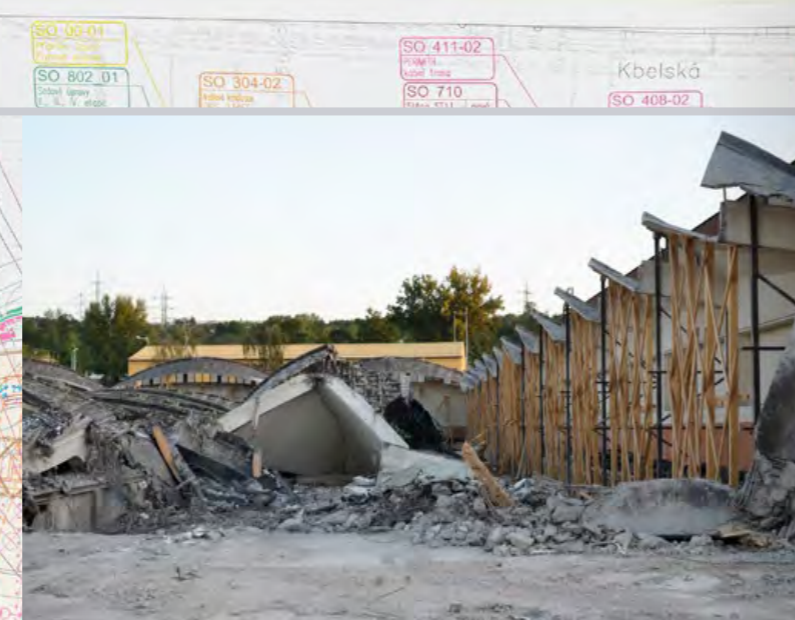
ROK NATO STAV Z POSTUPNÉHO ODKLÍZENÍ SUTĚ. VPRAVO NA SNÍMKU STĚNA HALY PODÚROVNĚHOVOU SOUSTRUHU
