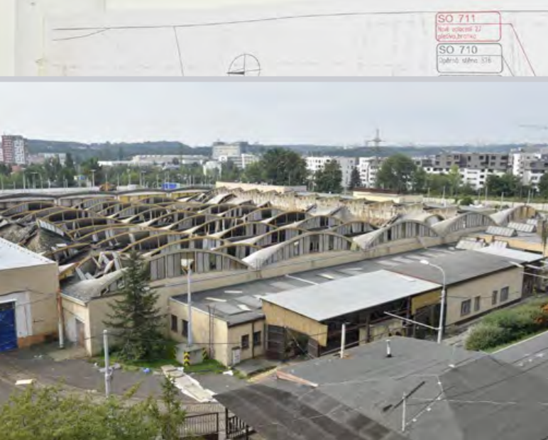
V SOBOTU 24. SRPNA 2019 V 9:26 HODIN PROBĚHL ODSTŘEL DEPONOVACÍ HALY VOZOVNY HLOUBĚTÍN. K SAMOTNÉMU ODSTŘELU BYLO POUŽITO CELKEM 126 KILOGRAMŮ PRŮMYSLOVÉ TRHAVINY V 902 NALOŽÍCH
